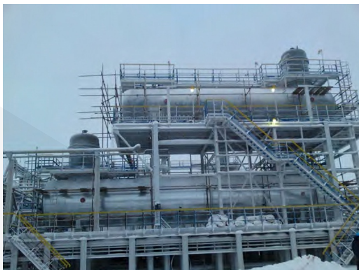
Установка MERICHEM в Нарьянмаре, ООО "Нарьянмарнефтегаз"
