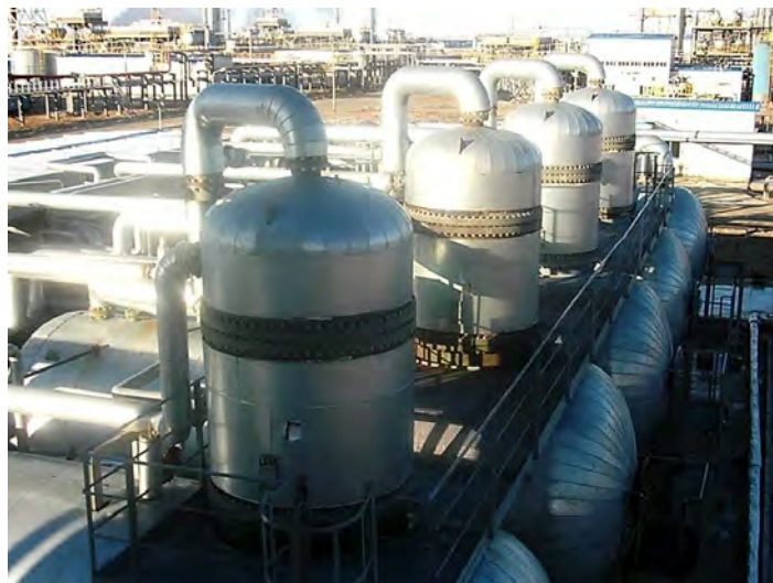
Установка MERICHEM на НПЗ "Жаназол", СНПС-АКТОБЕ
